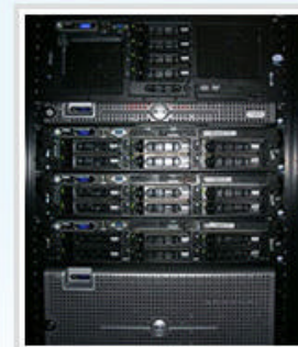
Dell R900, Nodos VPS y Cabina de Disco
