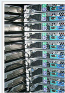
Cableado Corriente Servidores Dedicados
